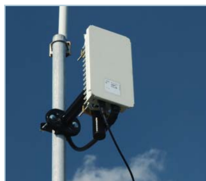
Venkovní radiová část základnové stanice BreezeMAX se všesměrovou anténou.
