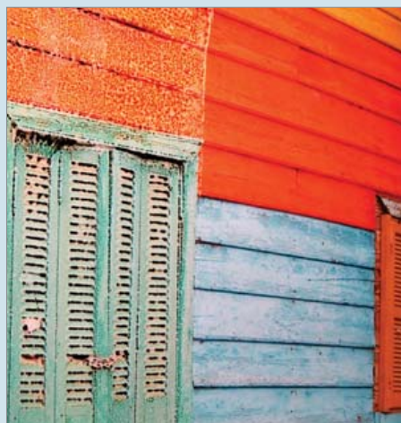
Na průhledné fólii je rozdíl mezi neošetřeným a ošetřeným povrchem výrazný.
